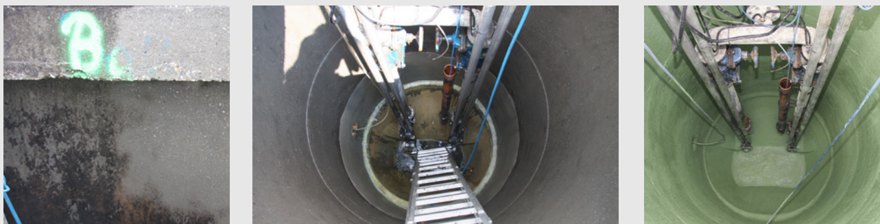
Bild 6: Betonkorrosion als dunkle Fläche links im Bild zu sehen, rechte helle Fläche bereits mit Granulat-Wasser-Gemisch gereinigt (links), gründlich gereinigter und vorbereiteter Untergrund (mittig), Pumpwerk nach Beschichtung (rechts)
