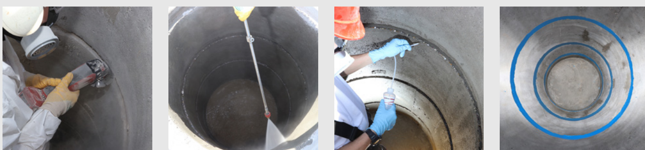
Bild 7: Vorbereiten der Fuge durch Fräsen (links), Reinigen der Fuge mit Hochdrucklanze (2. von links), Entfetten der Oberfläche (2. von rechts), abgedichtete Fuge (rechts)
